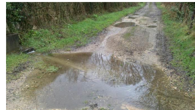
Ruissellement de l'eau, chemin des Tournelles
